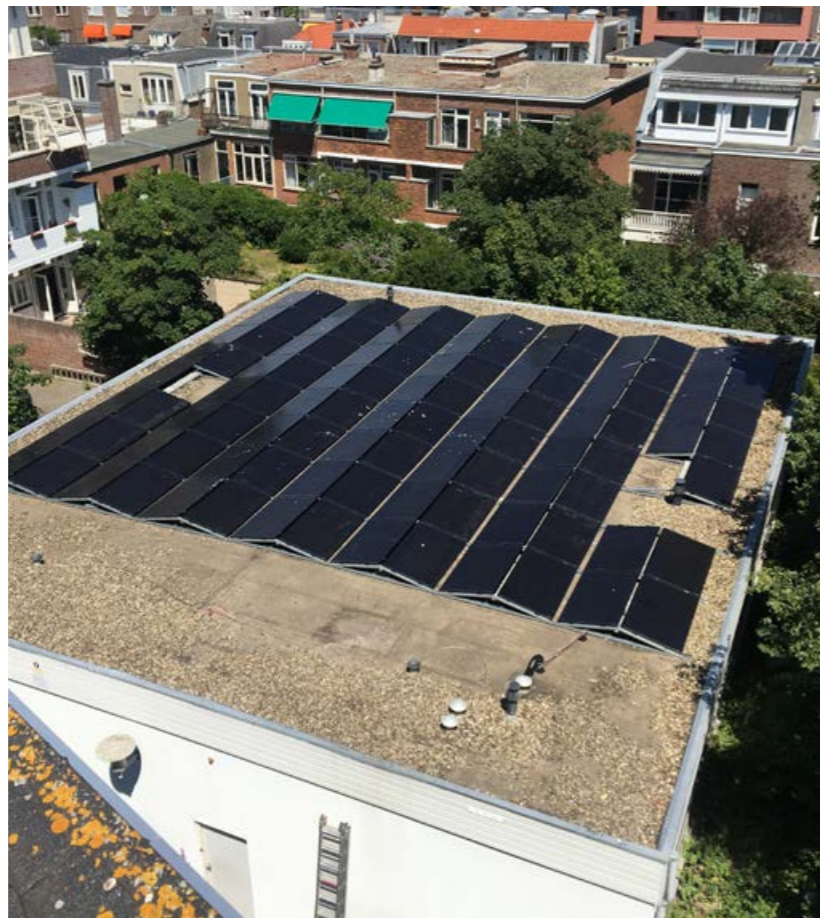
Zonnepanelen op dak van het bijgebouw
