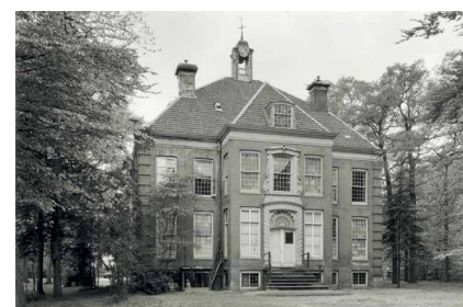
De achtergevel in vervallen staat, 1955.
