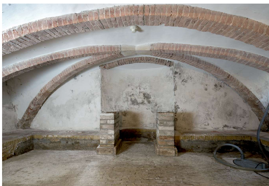
Kruisribgewelven met zandstenen sluitstenen in de kelder van het 16de-eeuwse Vegelin Huis.
