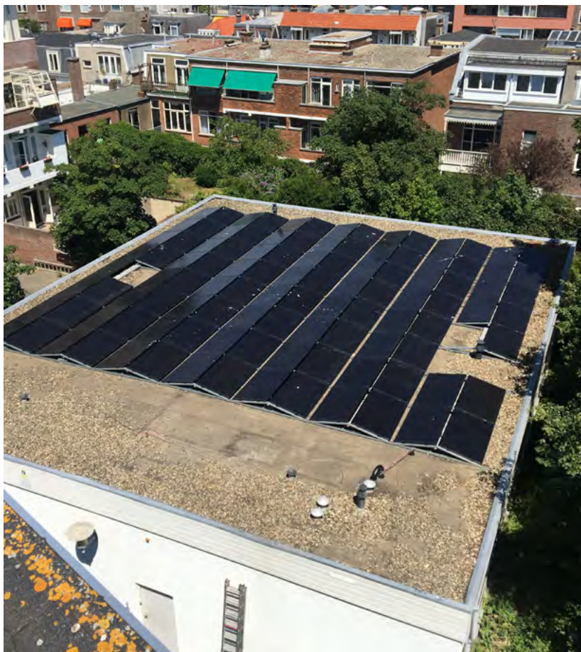
Zonnepanelen op dak van het bijgebouw
